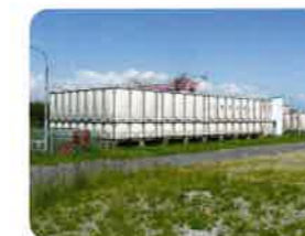
水処理プラント
