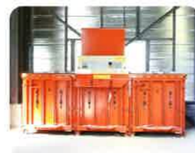
圧縮プラント
