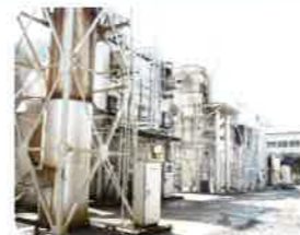
焼却プラント
